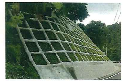
簡易吹付法枠
